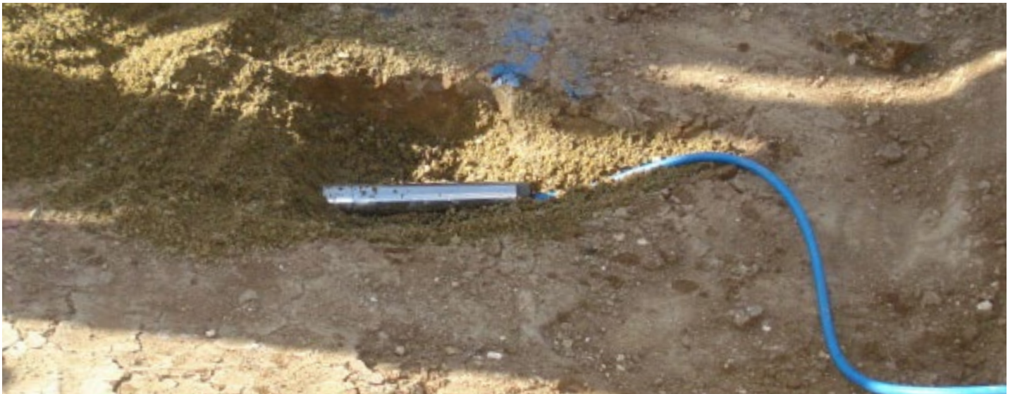
Piezómetro de cuerda vibrante en la cimentación de una presa de materiales sueltos
