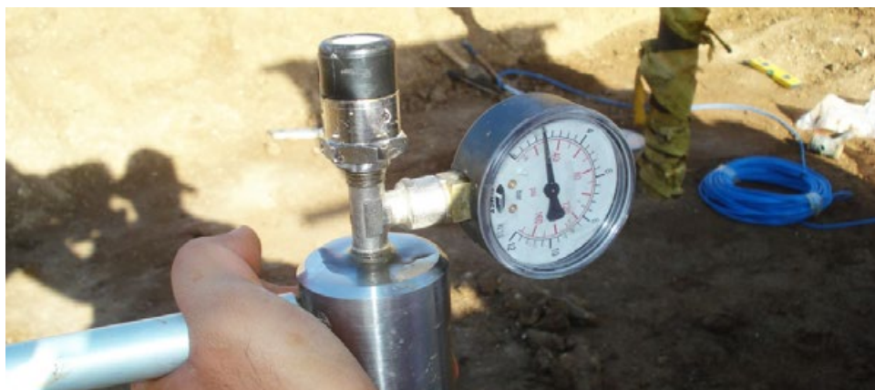
Saturación del filtro de HAE con dispositivo de saturación
