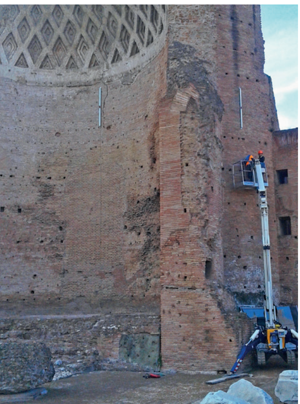
Instalación de Sensores Tilt Beam (TB) en Maxentium Basilica
